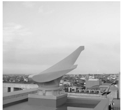
写真 - 4 自然排気式ベンチレーター
